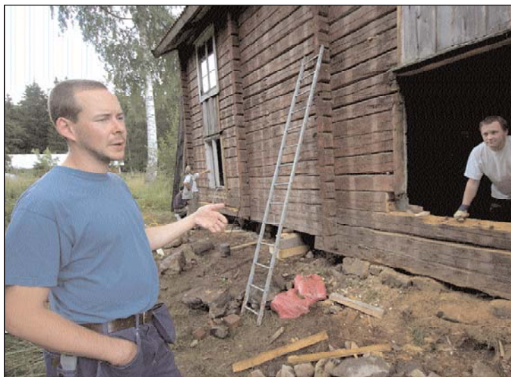
Solgruvstugan. När byggnadsvårdarna lättat på panelen upptäcktes att fler stockvarv än beräknat måste bytas. Martin Åhrén och visar.
